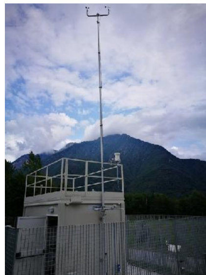
Stazione meteorologica su palo telescopico pneumatico h=10m. Installazione per cabina di analisi qualità dell'aria
