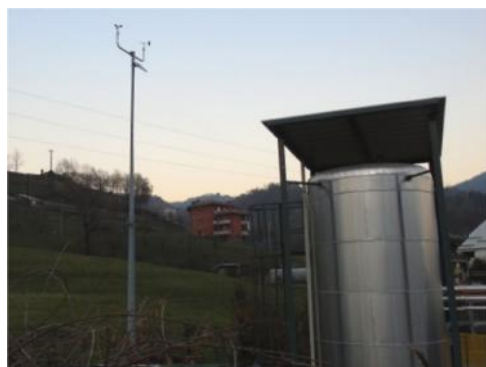
Stazione meteorologica con palo da 10m per il monitoraggio della dispersioni di inquinanti atmosferici (installazione in Impianto di cogenerazione)
